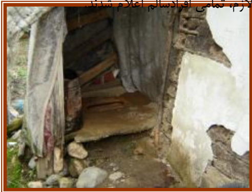
مستراح غیر بهداشتی قبل از اجرای پروژه
